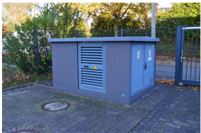
Trafostation an der nordöstlichen Flurstücksecke
